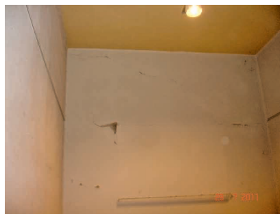
Φ. 6: Ρηγμάτωση εσωτερικά στο κτίριο
