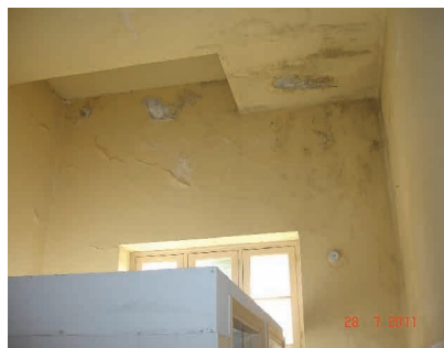
Φ. 11: Υγρασία εξωτερικά
