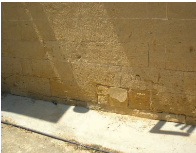
Φ. 8: Αστοχία λιθοσωμάτων
